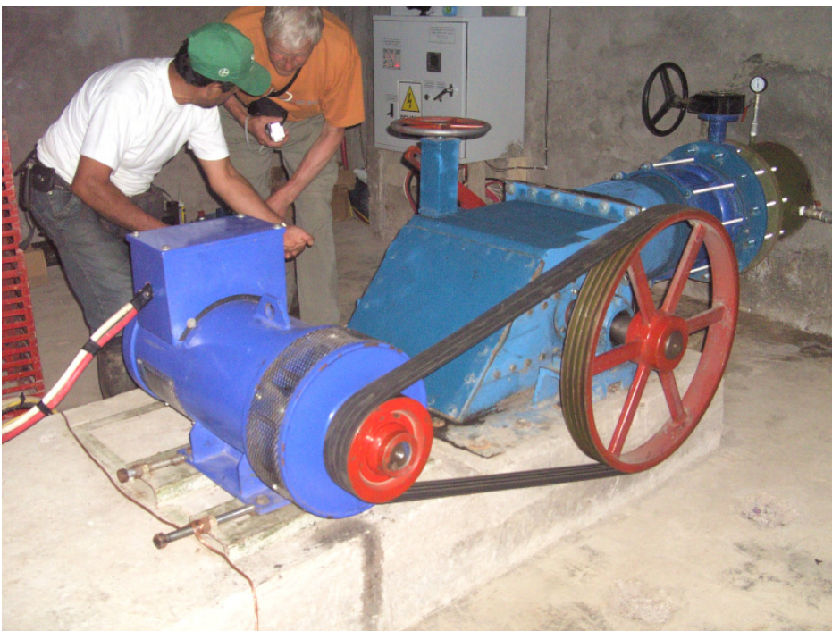
Bild von Turbine mit Generator und Schaltschrank
